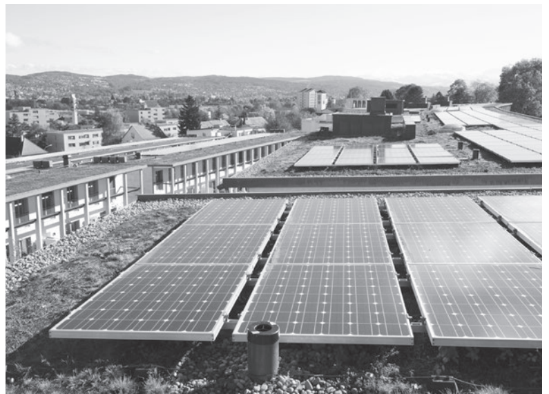
Die Photovoltaik-Anlage der FGZ-Siedlung Grünmatt im Friesenberg erzeugt jährlich gut 340'000 Kilowattstunden Strom. Das deckt den Strombedarf von 90 Wohnungen mit vier und mehr Personen.
